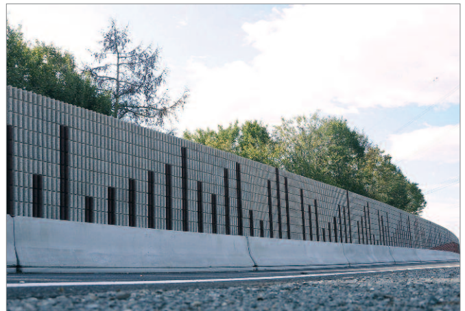
Bild 32: Leitwandsystem mit kombinierter Lärmschutzwand
