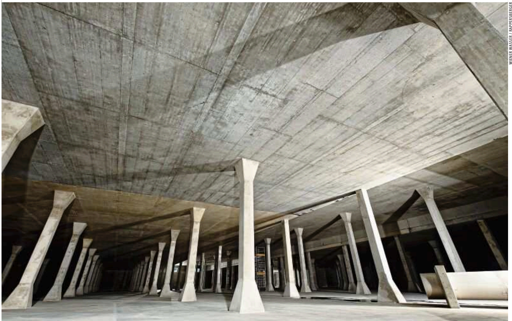
Ein seltener Anblick: Der 42 Millionen Liter fassende Wasserbehälter Wienerberg vor der Befüllung
