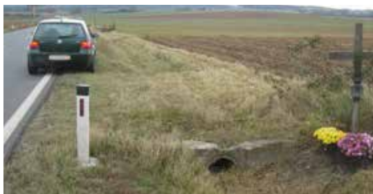
Bild 1: Auch ein kleiner Rohrdurchlass kann zur tödlichen Falle werden (Bild zur Verfügung gestellt von Dr. Dietmar Adam, TU Wien)
